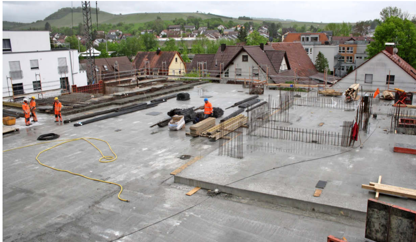
Die Deckenplatte des Erdgeschosses wird drei neue Gebäude mit insgesamt 24 Wohnungen tragen. Sie schließt direkt an das Bestandsgebäude an.
